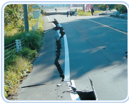
Fonte: Foto de Tubbi. Disponível em: < http://upload.wikimedia.org/wikipedia/commons/8/84/Chuetsu_earthquake-Yamabe_Bridge.jpg >. Acesso em: 28 fev. 2012.
