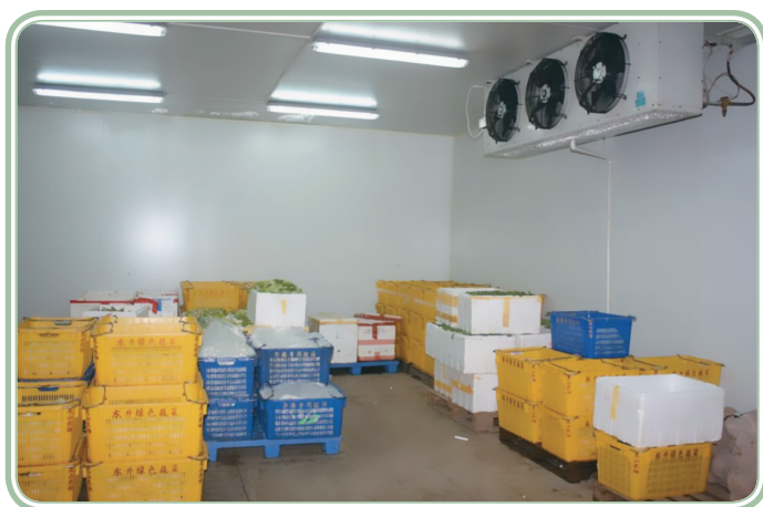
Figura 3.13: Câmara frigorífica com alimentos armazenados.
