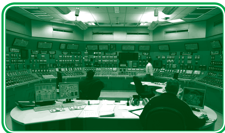
Figura 1.4: Sala de controle da usina nuclear de Angra dos Reis
