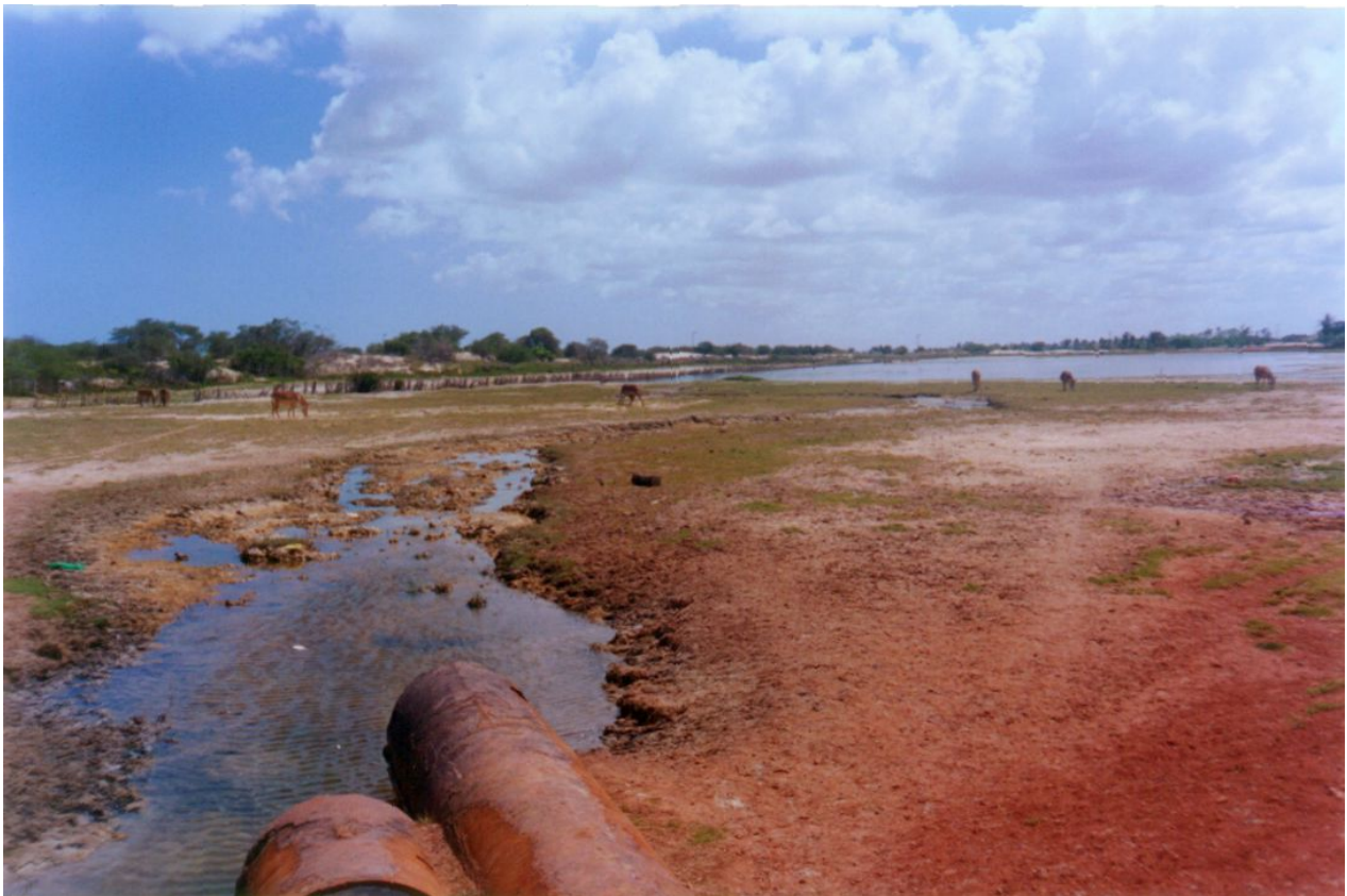
Foto 2 - Tubulações da saída da Lagoa pelo canal artificial para a área de manguezal ao fundo
