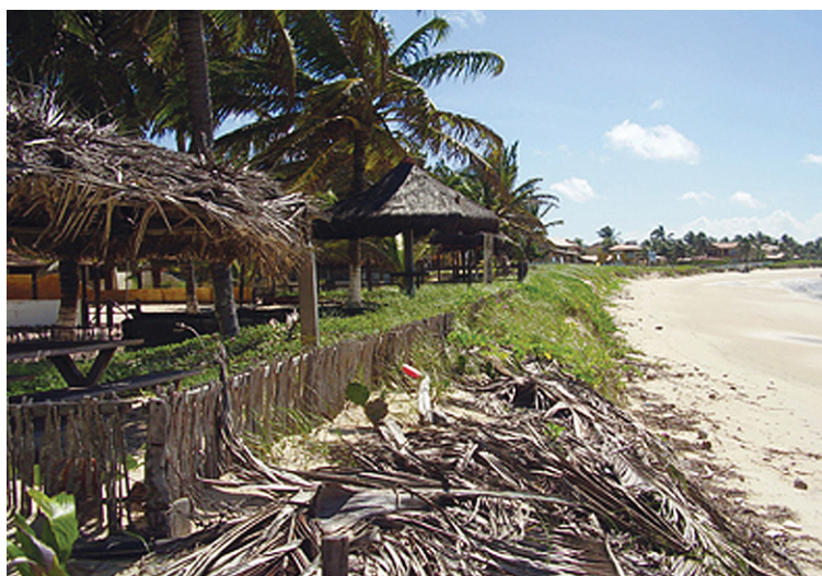
Figura 5 - Fotografia mostrando características da ocupação no pós-praia em área de planície arenosa e dunas, com imóveis avançando sobre a face da praia, em áreas submetidas a processos de erosão costeira.
